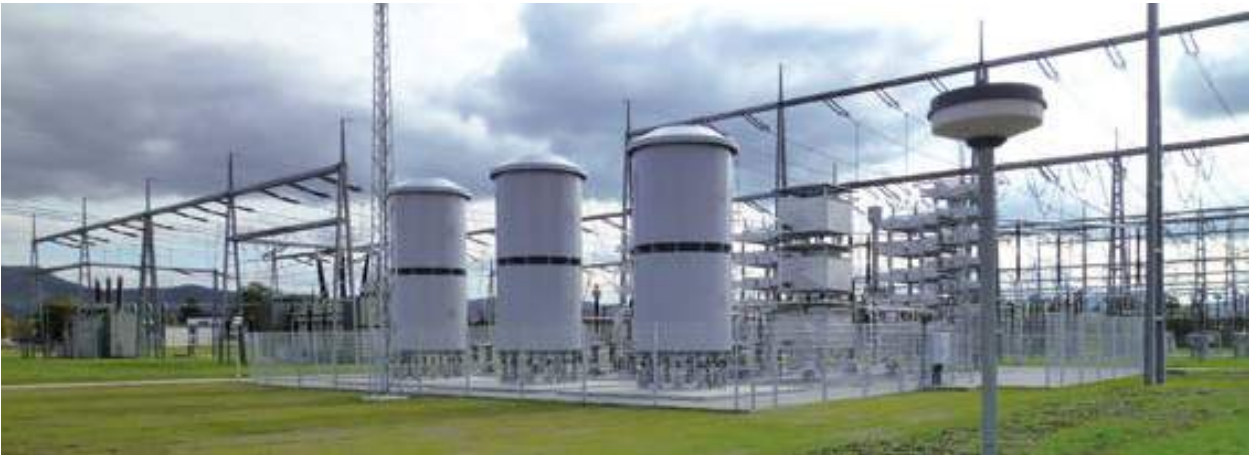
Blindleistungskompensationsanlage im Umspannwerk Engstlatt
