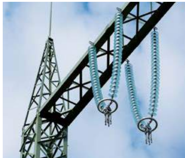
Isolator eines Hochspannungsmastes
