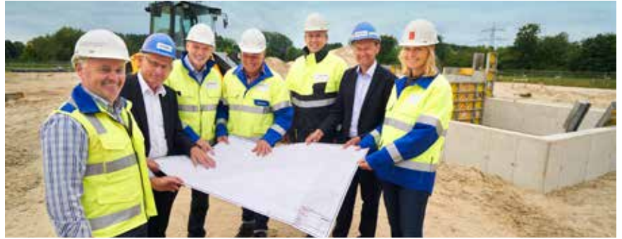
(Von links) Bürgermeister Franz Möllering und Bürgermeister Berthold Bültgerds (beide mit blauem Helm) erhalten einen ausführlichen Einblick in den Projektplan zum Baustart der Umspannanlage.
