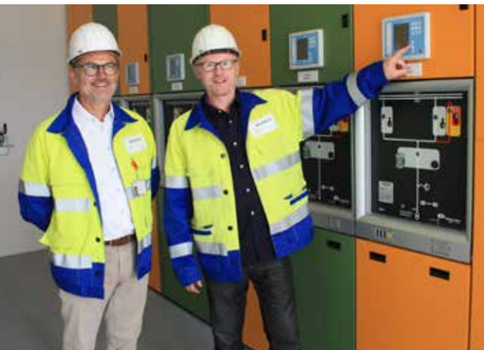
Blick hinter die Kulissen: Projektleiter Egbert Petermann (rechts) und Netzbetriebsleiter Michael Mühlenkamp von Westnetz stellen die Anlage in der Altfeldstraße vor.
