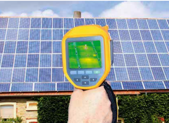
Ein Blick durch die Wärmebildkamera verrät, ob die Module der stromerzeugenden Solaranlage Mängel aufweisen.
