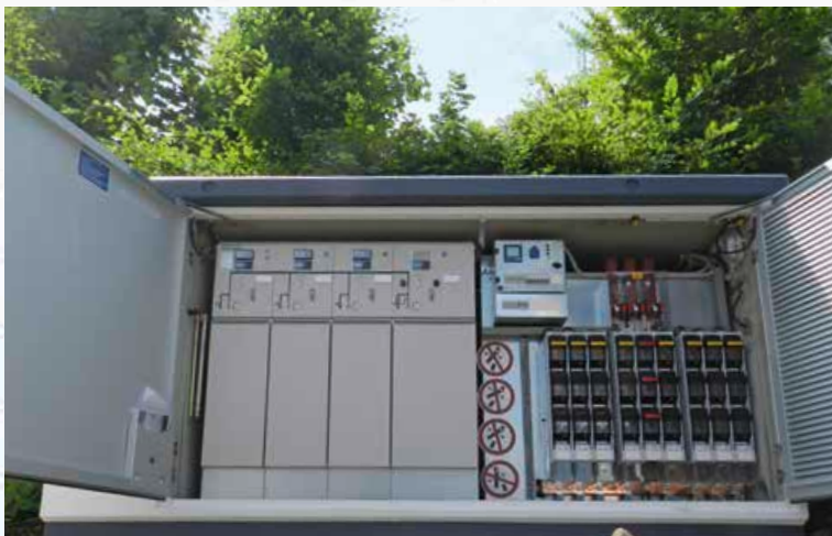
Unter anderem dank des Mobilfunk-LTE-Modems – einer kleinen unscheinbaren Box mit Antenne – lassen sich intelligente Ortsnetzstationen aus der Ferne schalten und überwachen.
